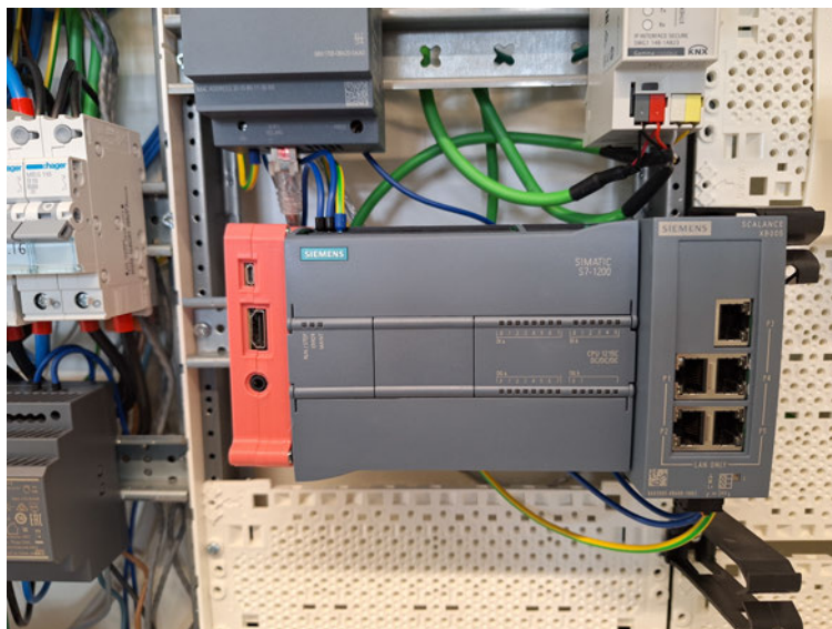
Abbildung 5: Eingebaute Bauteile 24 V Stromkreis
